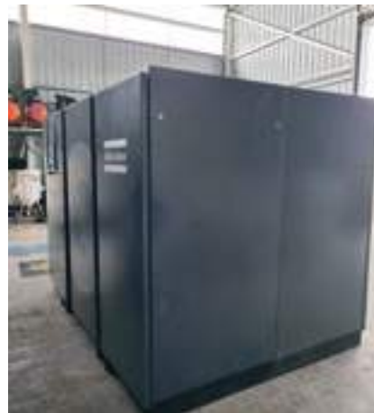
Exemple de compresseur électrique Atelier
