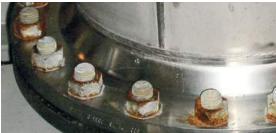
Corrosion galvanique d'écrou galvanisé au contact d'une vanne en acier inoxydable
