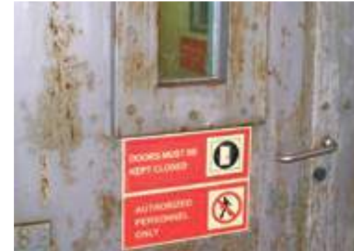
Corrosion d'une porte en acier inoxydable
