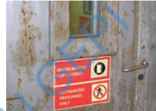
Corrosion d'une porte en acier inoxydable
